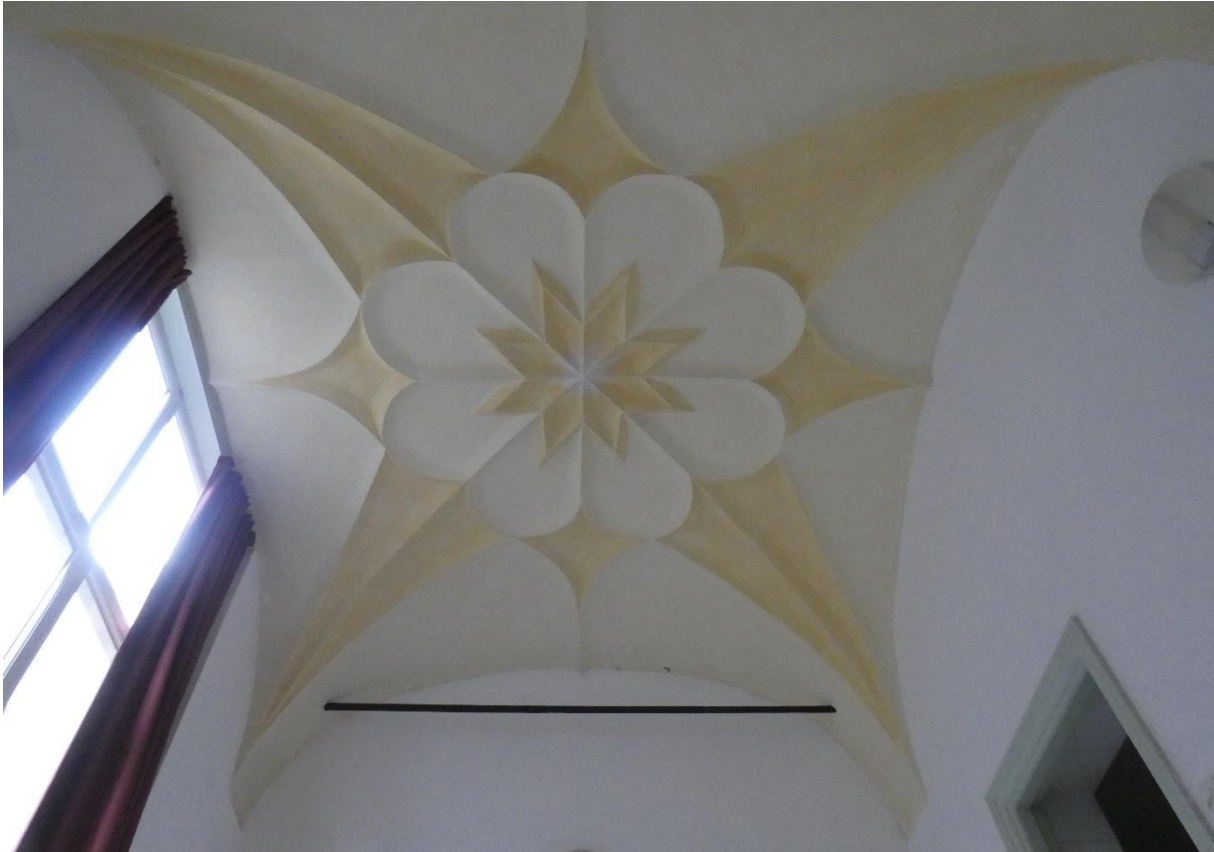
Het kruisgewelf van de torenkamer op de eerste verdieping van het achterhuis. Het gewelf heeft een kruisvormige versiering in pleisterwerk.
