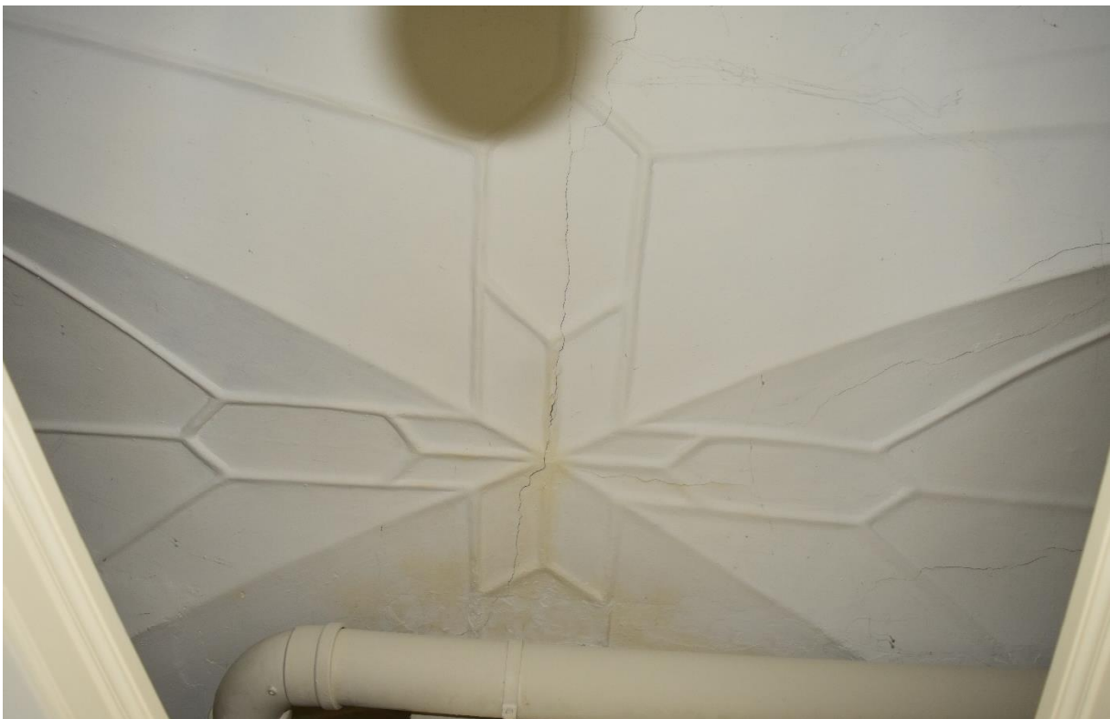
Het kruisgewelf in de achterraimte van de torenkamer op de begane grond van het achterhuis, voorzien van een stervormig stucdecoratie. Een deel van het gewelf is gesloopt bij plaatsing van de trap (17 de eeuw).
