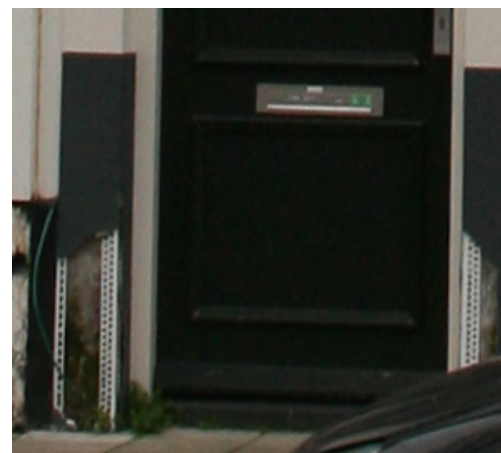
Foto boven: De gevel aan de Beeklaan. De linker pijl wijst op de ontlastingsboog boven de deur naar het trappenhuis van de bovenwoningen, Foto onder: De ter weerszijden van deze deur deels in het zicht gekomen metal stud constructie.
