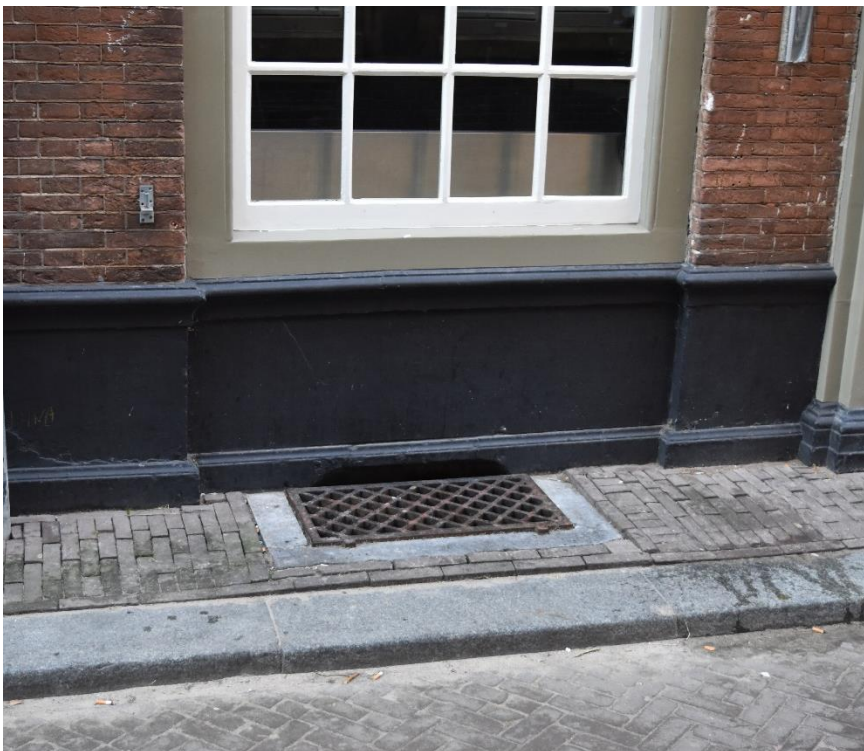
Het gietijzeren rooster in het trottoir voor de voorgevel, gevat in hardstenen banden (1980-'82).
