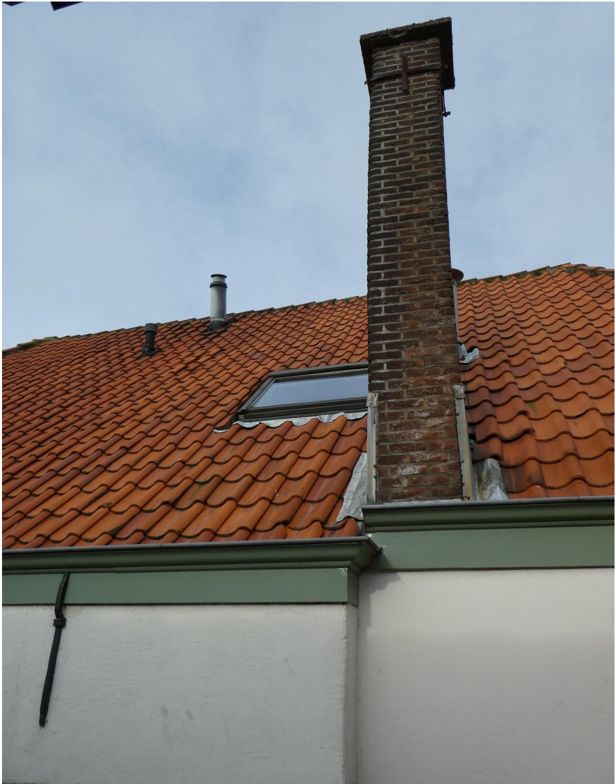
Het dak is gedekt met orangerode Oudhollandse pannen. Op het zuidelijke dakvlak is een schoorsteen uit 1948 herkenbaar, uitgevoerd in machinale baksteen.
