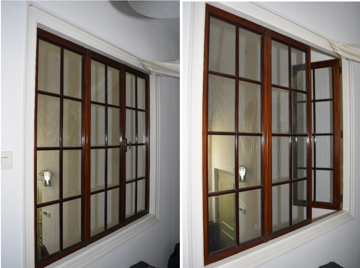
De pui op de overloop van het trappenhuis op de tweede verdieping, bestaande uit drie aaneengesloten achtruitsramen van gelakt mahoniehout.
