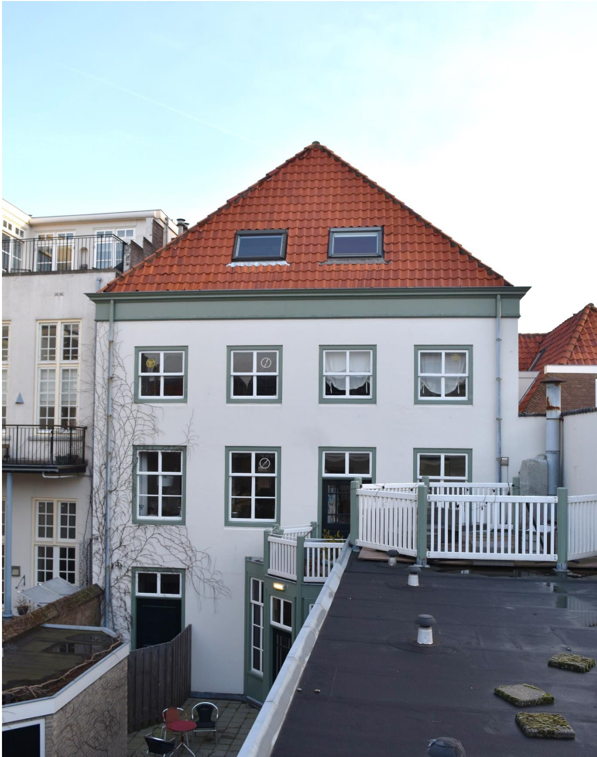
De achtergevel, gezien vanaf het platte dak van de aanbouw. De huidige indeling en afwerking dateert voornamelijk uit de periode 1980-'82, evenals de vensters en schuiframen.
