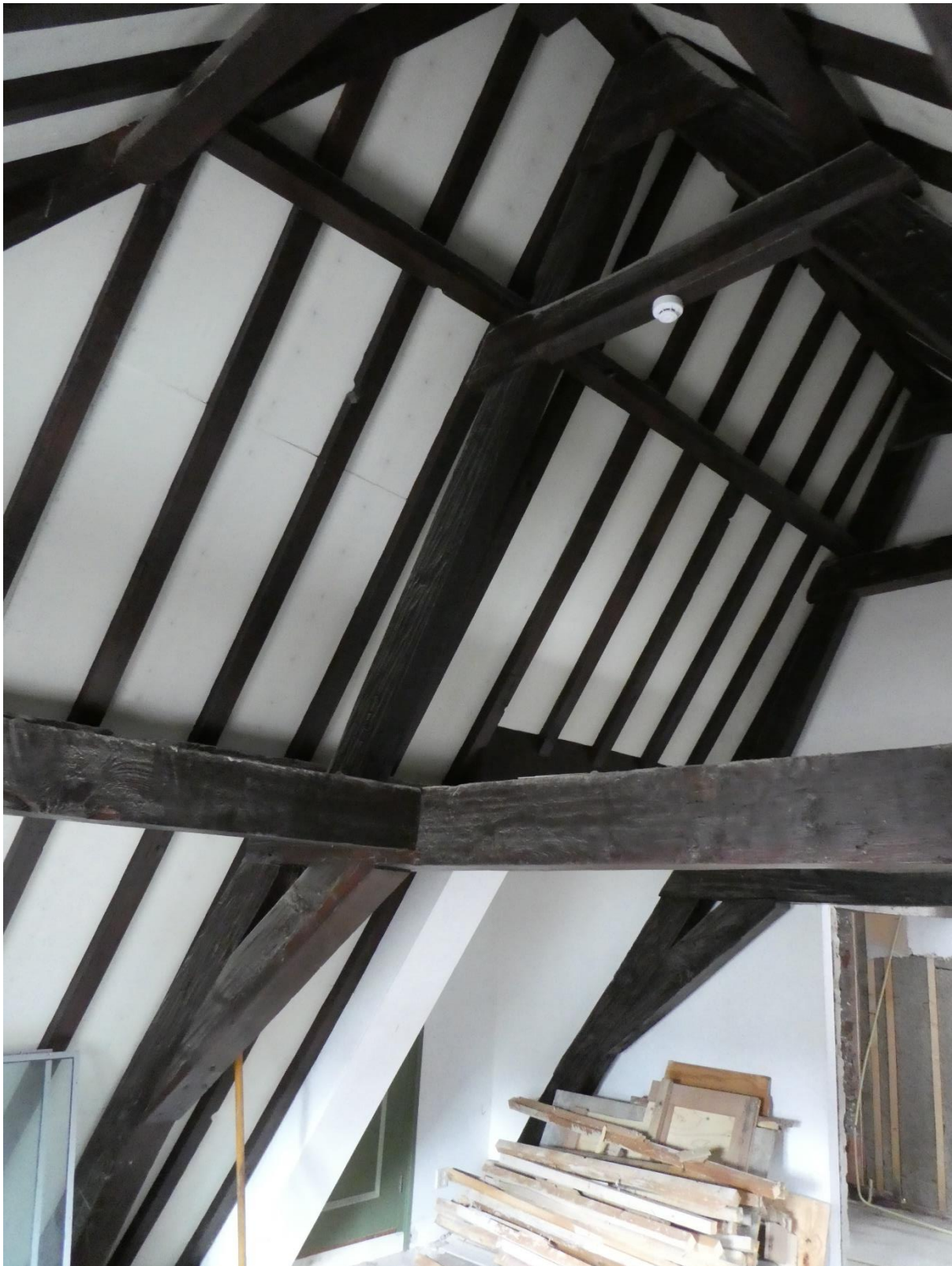
Overzicht van de kapconstructie van de dwarsvleugel. Er is sprake van stapelspanten, bestaande uit schaargebinten (zoldergebinten) en A-gebinten (vloeringgebinten). Ze zijn genummerd met de telmerken II en III.
