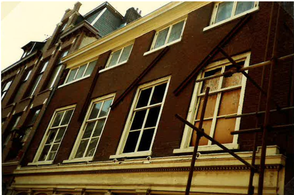
Het bovenste deel van de voorgevel in 1980 met stalen steunbalken, foto Snoeck aannemersbedrijf BV uit 1980 of 1981 (archieff Stadsherstel).
