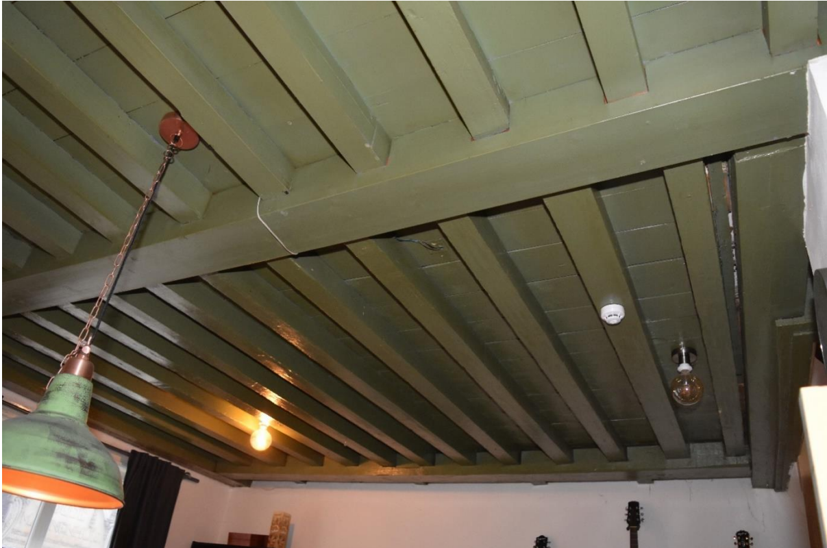
Overzicht van de samengestelde balklaag in de linkervoorkamer op de eerste verdieping, bestaande uit grenenhouten moer- en kinderbalken uit de late 17 de eeuw.
