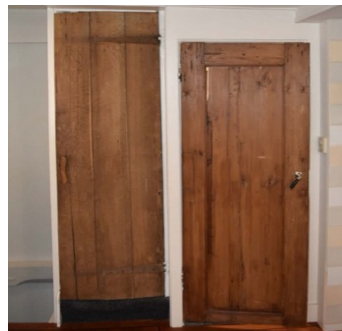
De twee herplaatste deuren op de tweede verdieping. Links is een eikenhouten strokendeur herkenbaar (17e of 18e eeuw) en rechts een naaldhouten paneel deur (19e eeuw).
