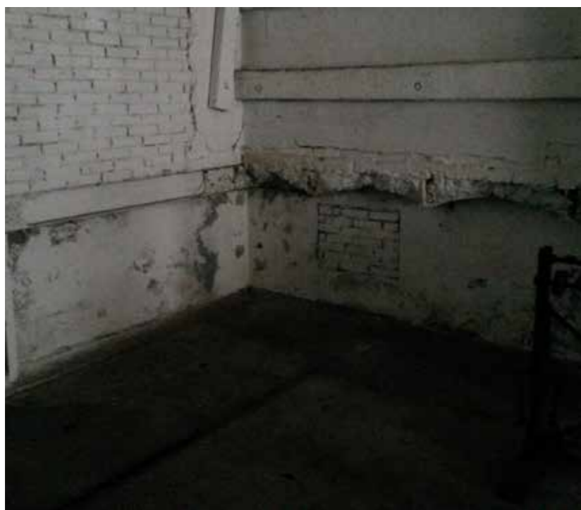
Beschadigingen aan de gevels
