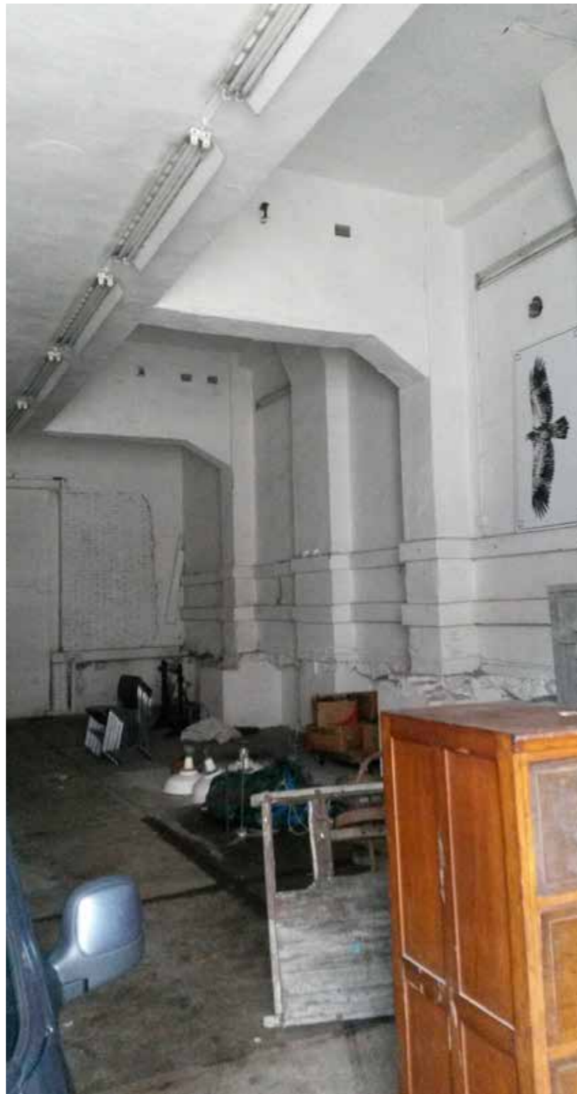
Beschadigingen aan de gevels
