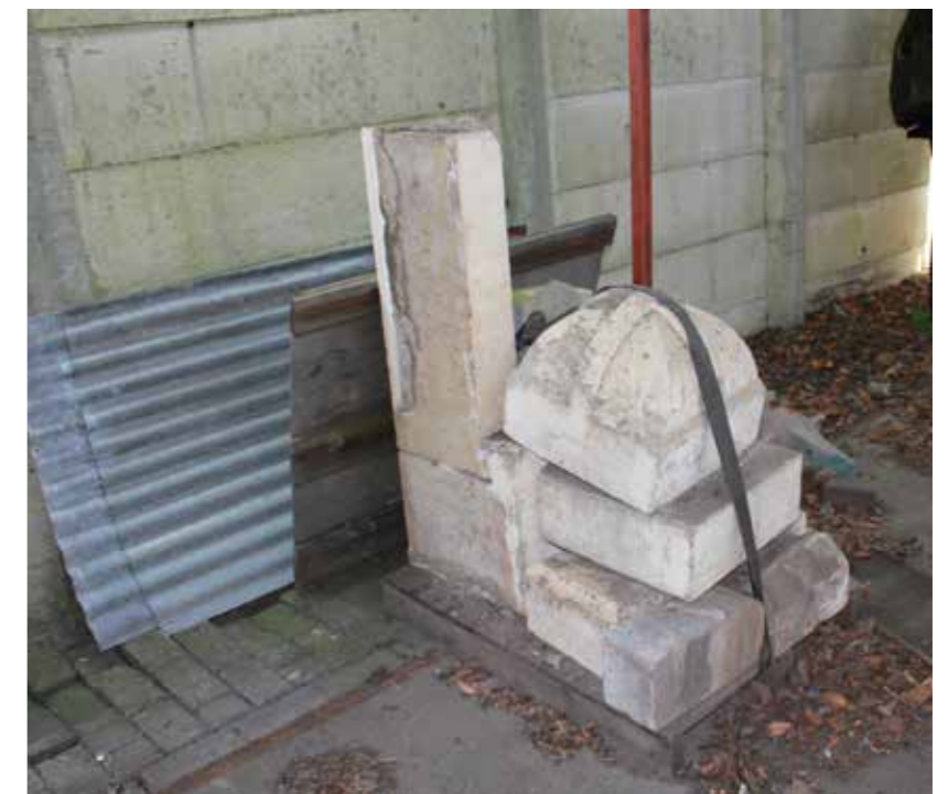
Oorspronkelijke natuurstenen afdekkers van de tuinmuur aan de paardengang
