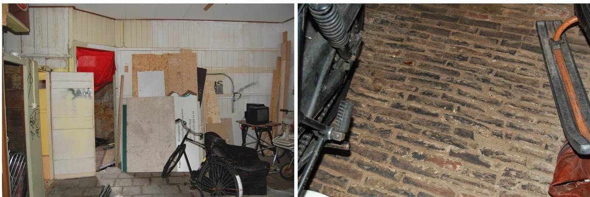
Links: de twee afgescheiden ruimten in het achterste deel van de linker bedrijfsruimte op de begane grond. Op de foto is een houten wand zichtbaar, bestaande uit stijl- en regelwerk met kraaldelen. Rechts: baksteenbestrating in een van de achterste ruimten in de linker bedrijfsruimte op de begane grond.
