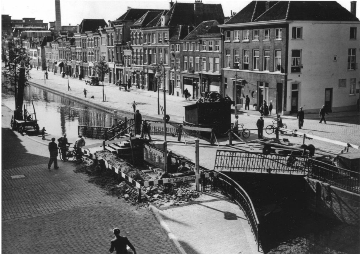
Overzicht van de Zuidwal tijdens werkzaamheden aan de brug over de Zuidersingelgracht, volgens een foto van 26 september 1947 (foto: HGA, 0.22589). De zijgevel aan de rechterzijde is geheel gepleisterd en geschilderd. De vensters op de eerste verdieping hebben hier nog T-schuiframes.
