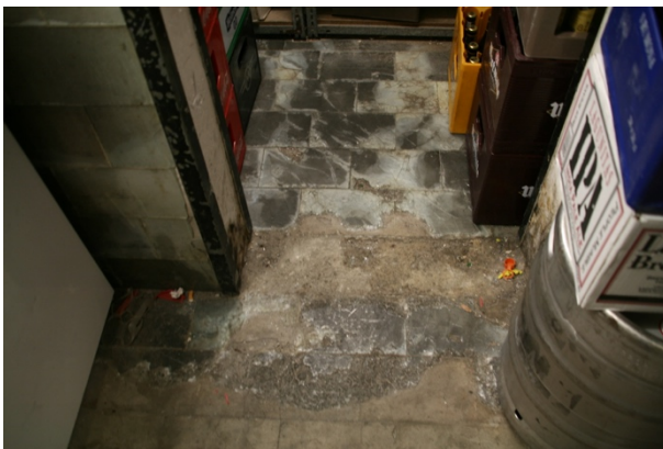
Op de voorgrond de vloer van het middelste reservoir. De tegels zijn hier vrijwel volledig weggesleten. Daarachter de glazen vloertegels van het achterste reservoir, die weliswaar veel slijtpatronen tonen maar nog niet geheel zijn weggesleten.
