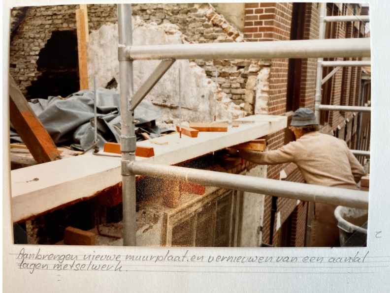
Foto tijdens de renovatie van 1981-1982. Te zien is een gedeelte van de rechter helft van het pand ter hoogte van de bovenzijde van de tweede verdieping en van de zolder. Uitsnede uit het fotoboek "1980-1981-1982 Foto's van de Restauratie van de Panden 20, 22, 24, 30, 52, 40 Oude Molstraat te 's-Gravenhage", dat op 27 mei 1982 werd aangeboden door Snoeck Aannemersbedrijf B.V. aan Stadsherstel Den Haag. Herkomst: panddossier Stadsherstel Den Haag.
