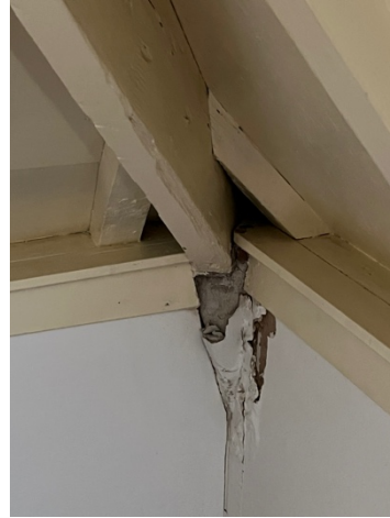
Linker hoek tegen de voorgevel. De pijl wijst op een vermoedelijk restant van een vóórgaande kapconstructie.
