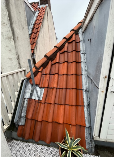
Het gedeelte van het achterste dakschild links van de deuropening, gezien vanaf het dakterras.
