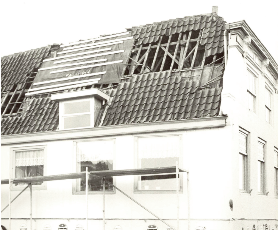
Afb. 15) Foto uit 1973 met de stormschade aan het dak. (GAL, F 1973-5, Idnr. 4914)
