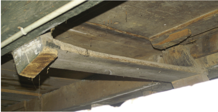
Afb. 57) Het restant van een laddertrap, mogelijk nog uit omstreeks 1800, naar de eerste verdieping.
