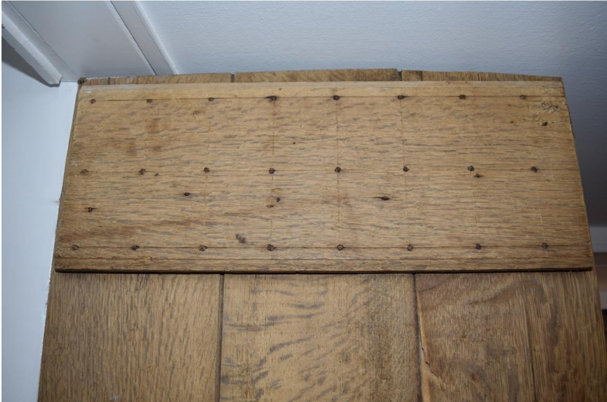
De bovenklamp van de eikenhouten klampdeur, voorzien van een rasterpatroon voor een regelmatige doortimmering. De deur is aan de bovenzijde verzaagd.
