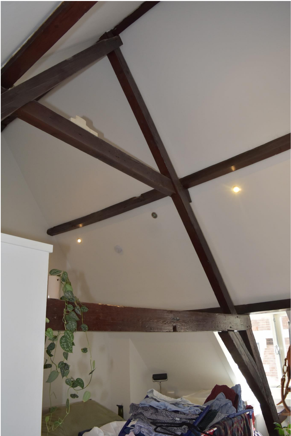
Overzicht van het spant op de zolder van Molenstraat 3/ 3A, bestaande uit een zoldergebint en vlieringgebint (A-gebint) voorzien van wurmten/ flieringen en een nokbalk.
