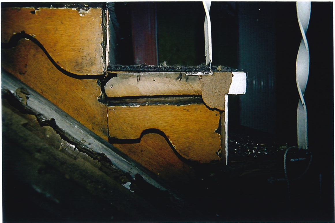
Afb. 22) De eiken bordestrap naar de verdieping is uitgevoerd met sober geprofileerde kardoezen (A) op de boom (B) en dateert mogelijk nog uit de 18de eeuw, maar lijkt secundair in het pand te zijn verwerkt. Gelijk met het vervangen van de bij de trap behorende leuning door de huidige metalen (C) in de jaren vijftig van de 20ste eeuw, zijn mogelijk ook de treden omgekeerd (D) en deels afgezaagd. Oorspronkelijk staken deze buiten de boom. De aftekening van het omgaande treeprofiel is nog zichtbaar (E).
