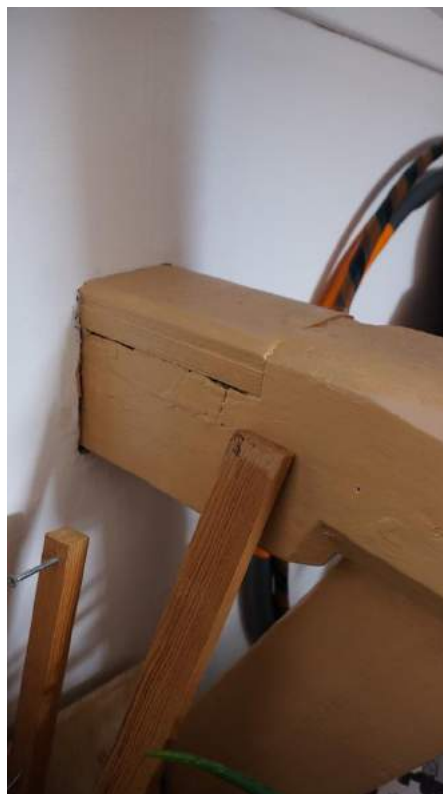
Afbeelding 41 (rechts) – Het blokkeel heeft een reparatie ondergaan met een las.
