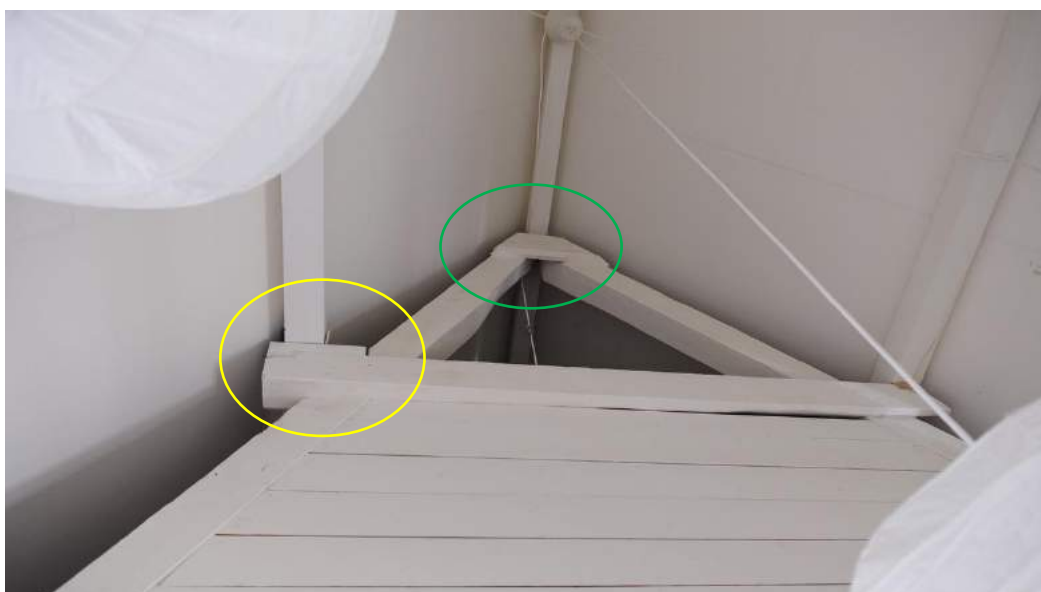
Afbeelding 21 (onder) – De overkepte balk van het schaarspant is aan de achtergevelzijde opgehoogd om de fliering te kunnen dragen (gele cirkel). Ter plaatse van de nok is de constructie verstevigd met een houten schetsplaat (groene cirkel).
