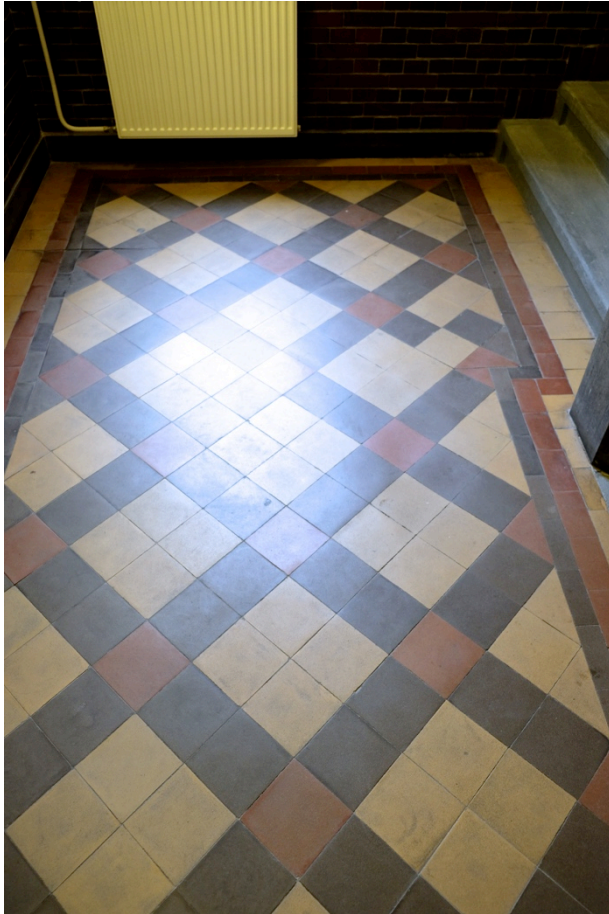
Afbeelding 45 Tegelvloer op de bordessen van de centrale trap. Voor de tweede traparm zijn twee tegels verkeerd teruggeplaatst, waardoor het patroon doorbroken is.
