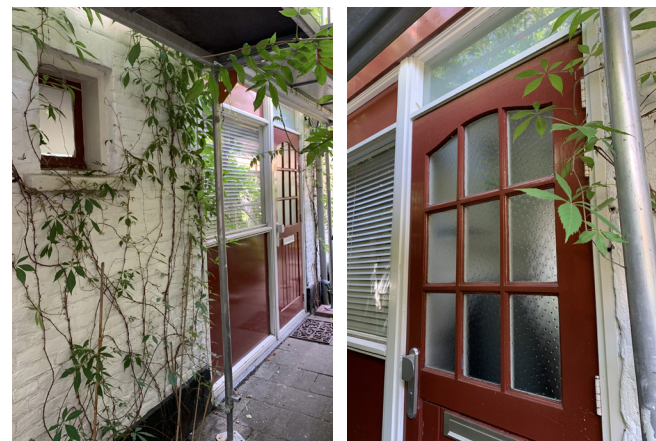
150. Voorgevel 105C met een detail van de deur en raam met bovenlichten.
