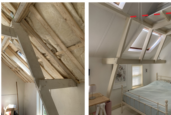
201. Spant in 105B. En spant in 105C met ontbrekende hanenbalk.
