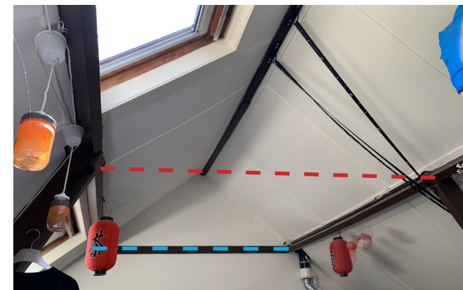
204. Kapconstructie in 105E met ontbrekende hanenbalk (rood) tussen de spanten, maar mét hanenbalk in de woningscheidende wand (blauw).
