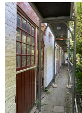
136. De gang langs de voorgevel van het hofje, rechts het einde (105A).
