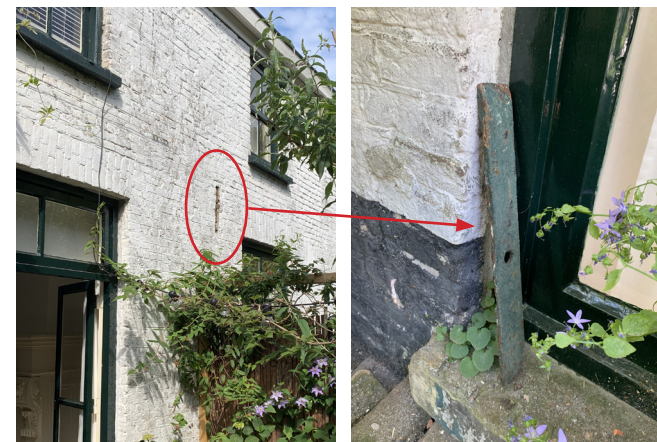
197. Uitgevallen gevelanker tussen 105C en 105D.
